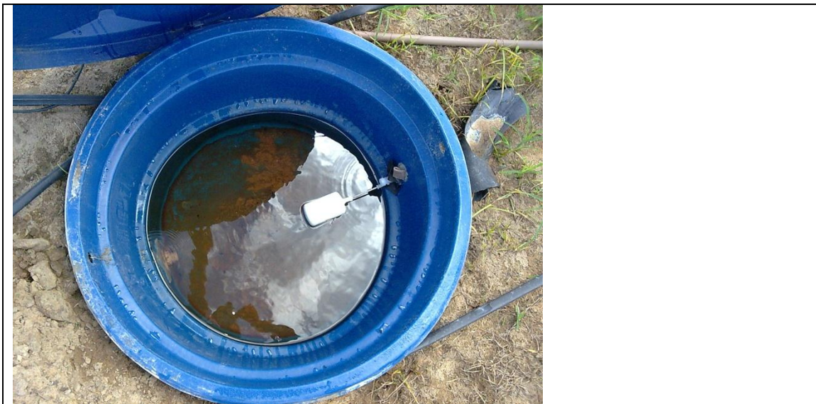
Figura 2 – Caixa de passagem para manter o nível da água constante
