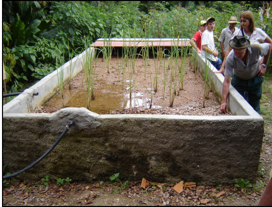
Figura 1. Sistema de tratamento de água, usando zona de raízes, construído a partir das informações geradas pelo monitoramento hídrico na comunidade da Concórdia, Lontras, SC.
