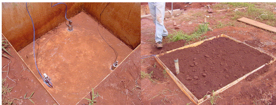
Figura 1. Vista geral do lisímetro de três células de carga, apresentando a caixa externa (a) e o conjunto, após a colocação da caixa interna (b).
