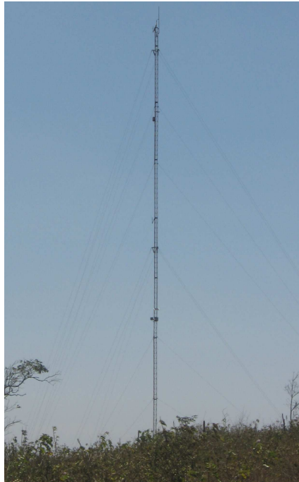
Figura 1: Vista da torre anemométrica.
